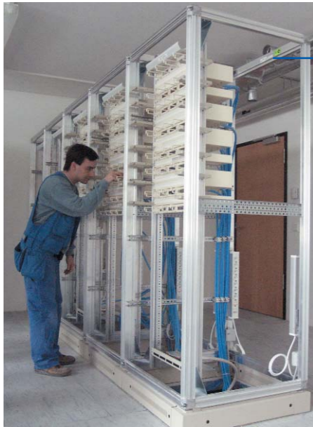
Letzte Handgriffe an einem VF 45 Hauptverteiler
