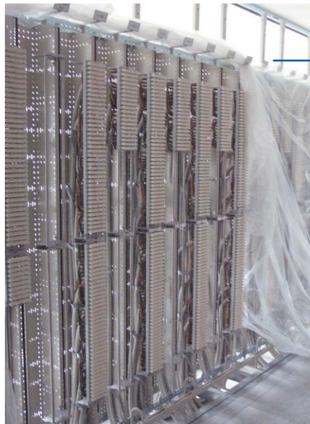
Zur Zeit sind neben einer LWL-Arbeitsplatzverkabelung (Fiber to the Desk) für die Telefonie noch Kat3 Kupferverkabelungen erforderlich. Foto: Gebäudehauptverteiler für 10000 DA in LSA-Plus Technik
